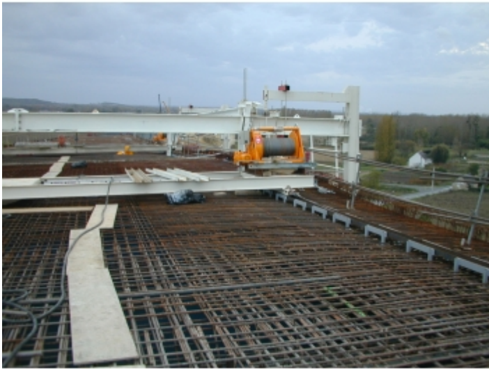
Installation sur un ouvrage d'art
