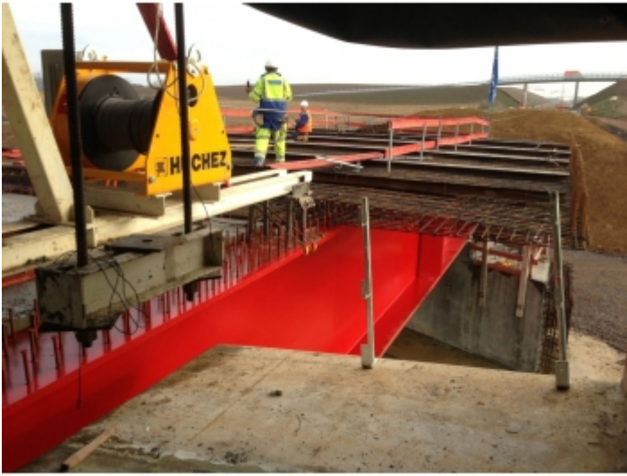
Installations sur un ouvrage d'art
