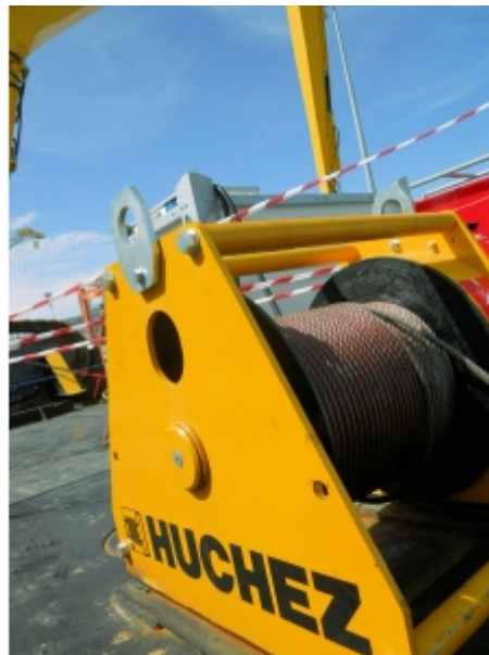
Installation sur un port maritime
