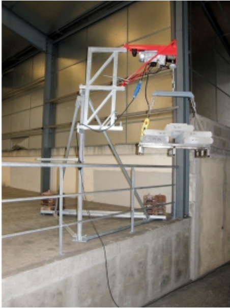
Levage de charges
