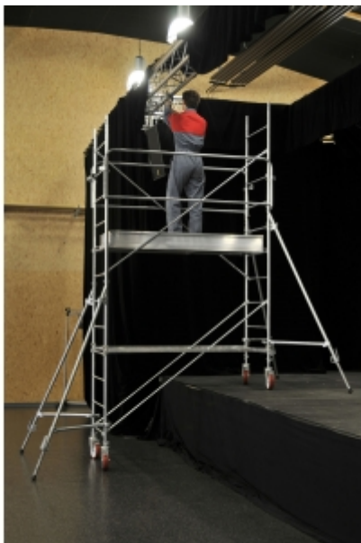
Installation en intérieur
